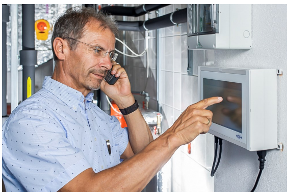
Dank der Installation können heute Unregelmässigkeiten, wie zu niedrige Temperaturen oder defekte Ventile und Sensoren, schnell erkannt werden.
