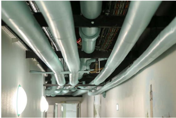
Fünf verschiedene, weit verzweigte Rohrleitungssysteme ziehen sich durch den gesamten Gebäudekomplex.
